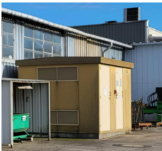
Photo 7 : Poste de livraison HT et TGBT.
